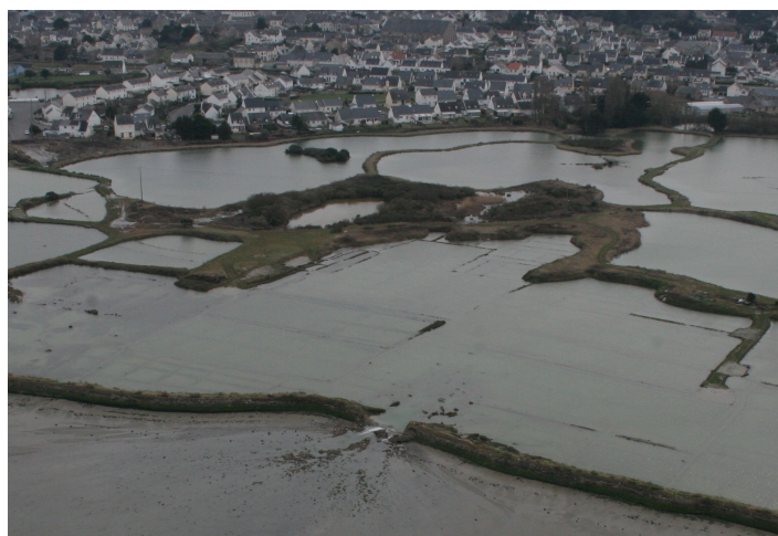
Brèche de digue dans les marais salants de Guérande lors de la tempête Xynthia.
