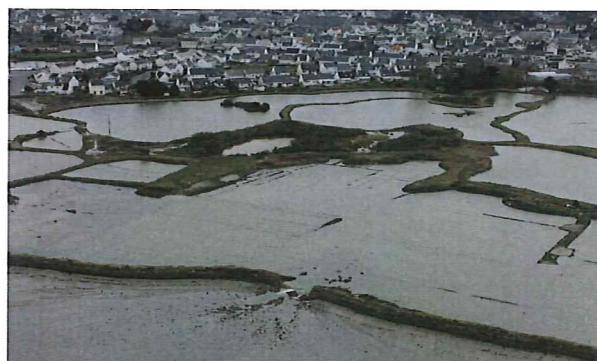
Brèche de digue lors de la tempête Xynthia
