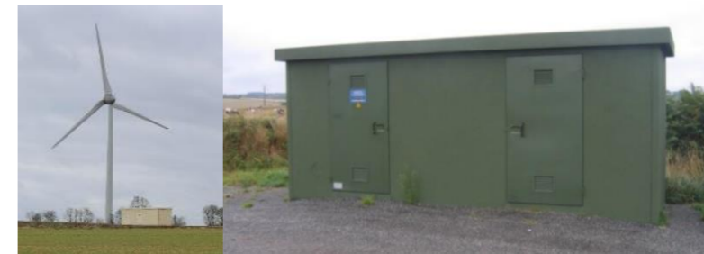
Exemples de poste de livraison électrique
