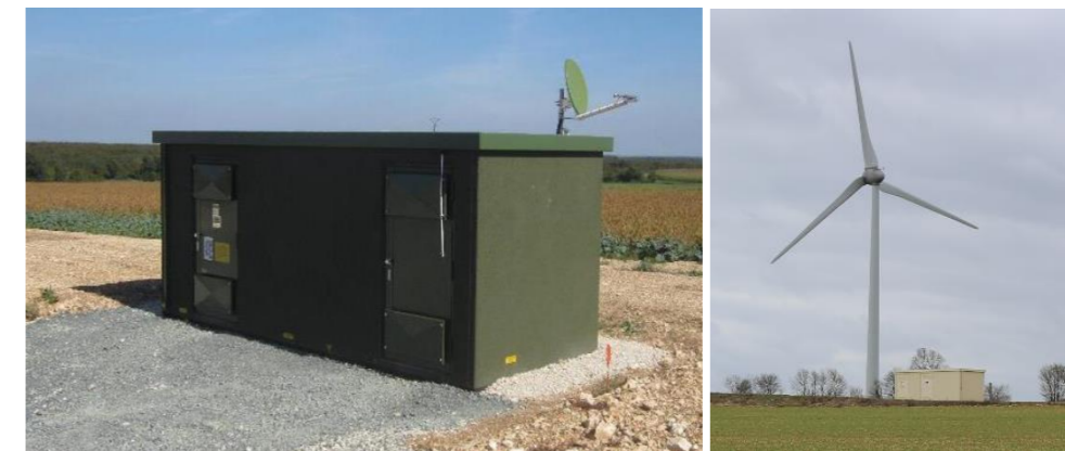
Un exemple de poste de livraison électrique
