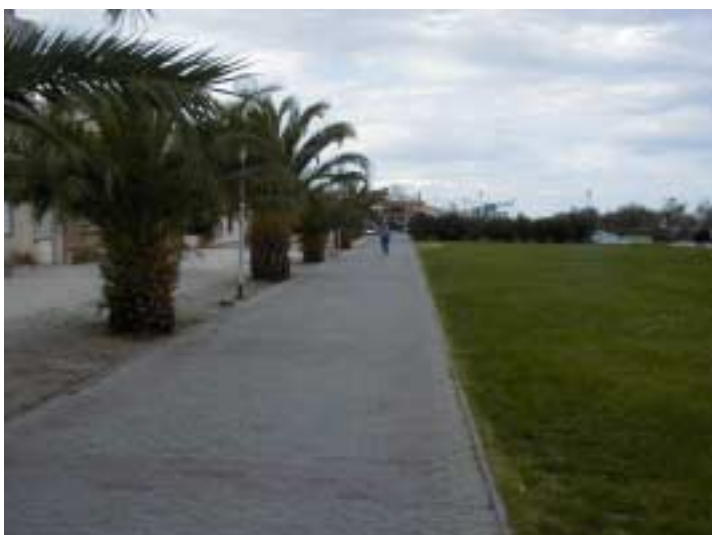
Tranchée drainante sous voirie à Argelès-sur-mer Source DDE 66
