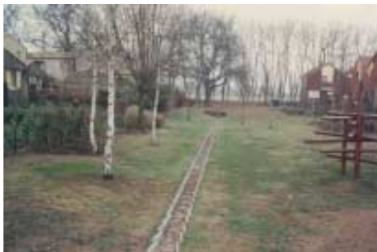
Noue et cunette en béton à Villabois Bruges (33) Source CETE du Sud-Ouest
