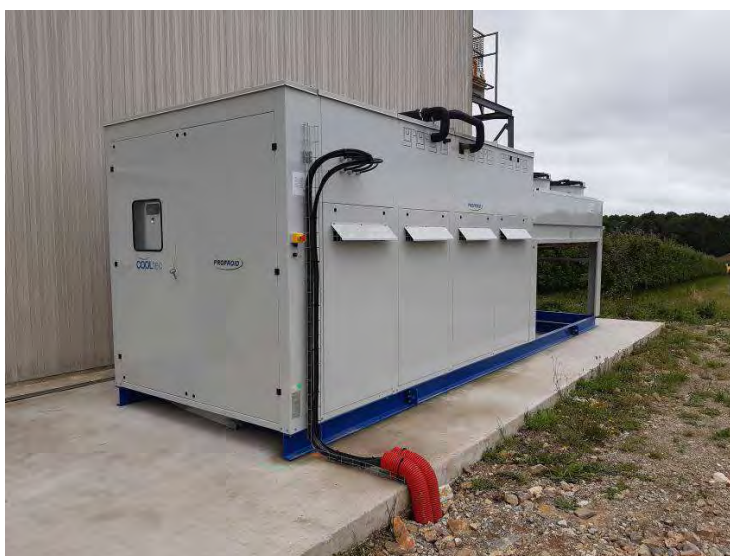
Figure 1 : Installation de réfrigération des Vergers du Littoral (à 35 m du point ZER2)
