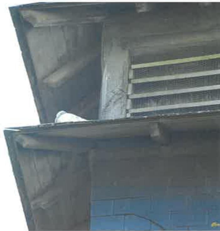
Illustration 2 : rebords de la chapelle de la Recouvrance pouvant être propices à l'installation des nichoirs artificiels.
