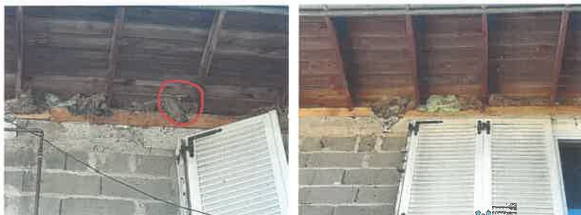
Présence d'herbes sèches et d'un oiseau noir indéterminé en haut de la façade du bâtiment.
