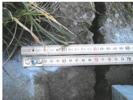
Fissure entre le tablier du pont et les bajoyers de l'ouvrage
