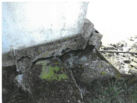
Fissure entre le local technique et le socle de l'ouvrage
