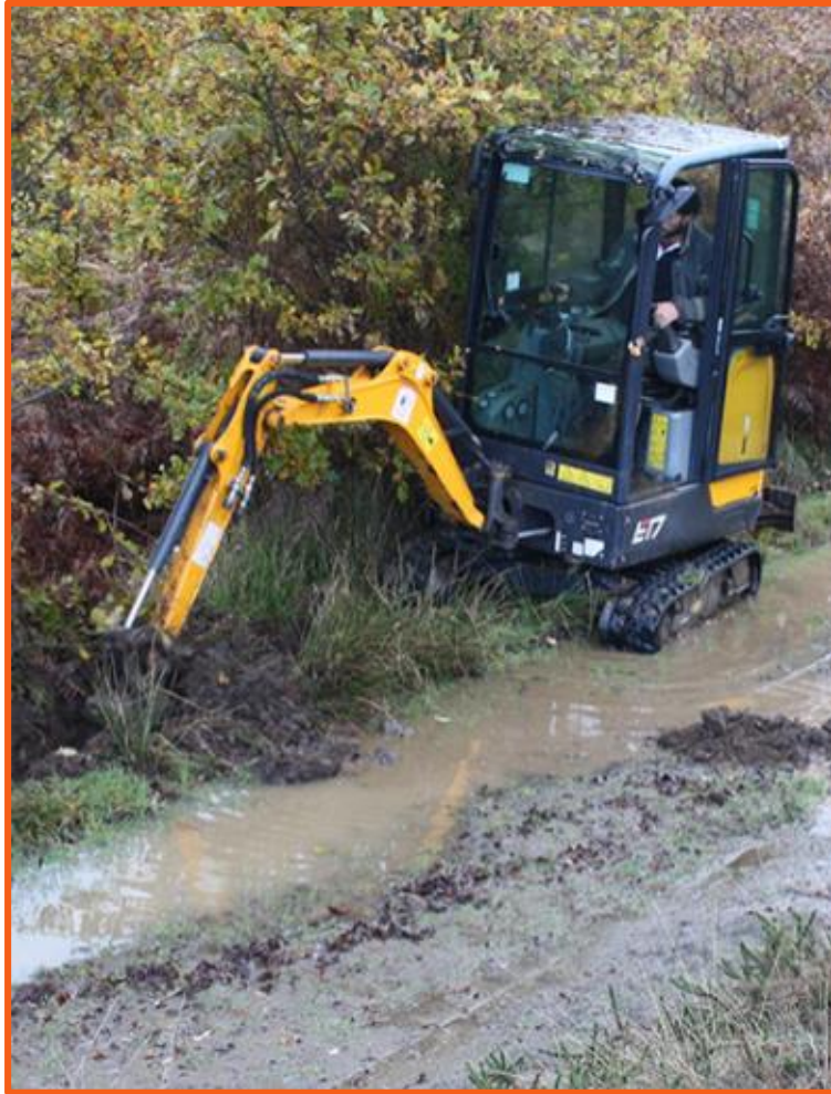
1. Ornières résultant du chantier
