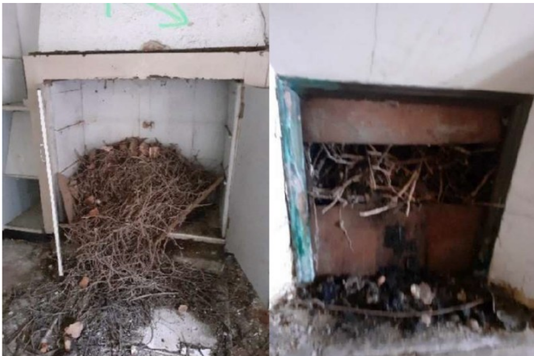
Branches de nids de choucas, tombées en bas de cheminées (nombreux cas dans le bâtiment) (visite du 17 mai 2022)
